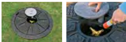
Tankabdeckung auf dem Rahmen der Schachtverlängerung
