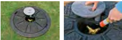
Tankabdeckung auf dem Rahmen der Schachtverlängerung
